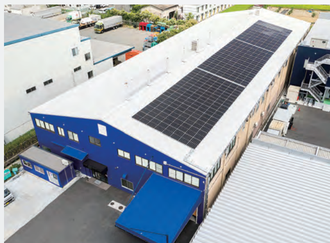
トキワ印刷社屋の屋根に設置された太陽光パネル
